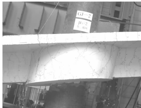
图5 环梁内斜裂缝发展图
