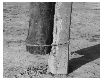
图 7 加固处理的电线杆
