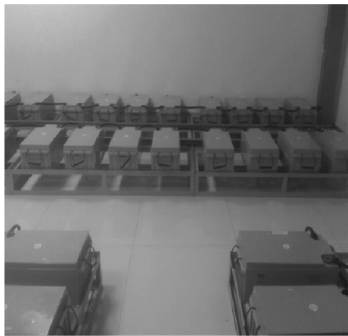
(a) UPS 电源室
