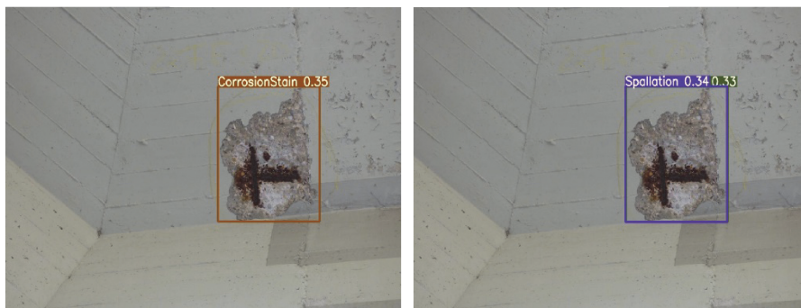
(b) 左:检测出腐蚀; 右:检测出腐蚀、脱落
