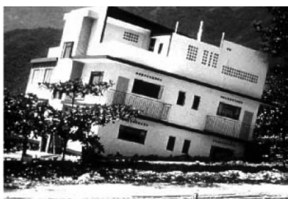
图1 地基土液化楼房下陷
