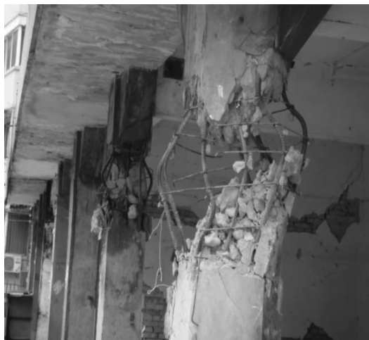
图4 汶川地震后都江堰某建筑柱灯笼型破坏形态
