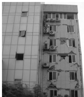
图1 都江堰市某办公楼外部损坏
