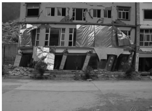
(b) 底框结构震害
