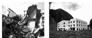
严重破坏(汶川地震) 基本完好(汶川地震)
