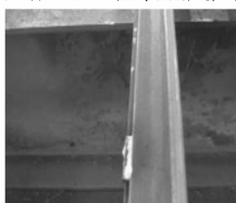
(c) 工字钢和一角钢组装错位
