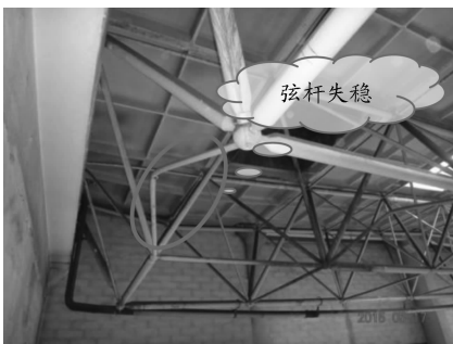
图2 钢网架弦杆失稳事故
