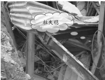
图1 钢结构加层事故
