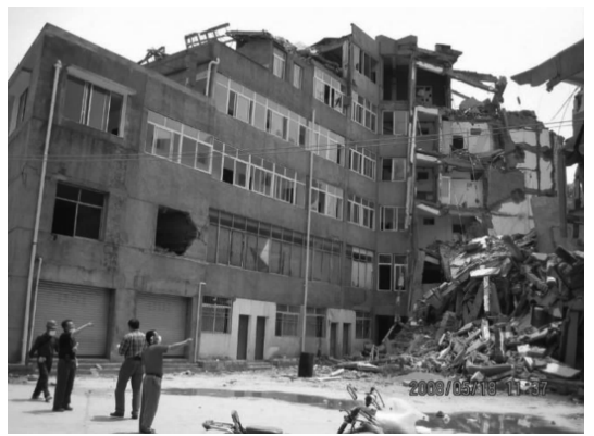
图1 汶川地震中结构震害图片
