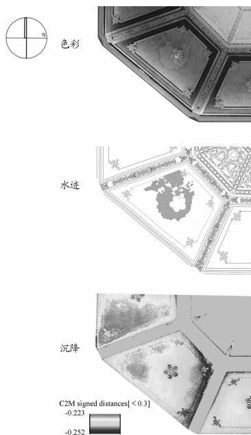
图3 融合了激光扫描、摄影测量、CAD 矢量图的藏经楼天花病害记录(作者同图2)
