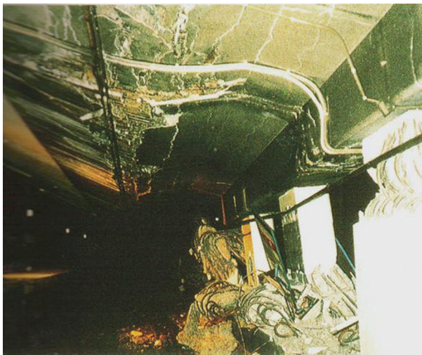
图5 神户地震中大开车站发生严重损坏
